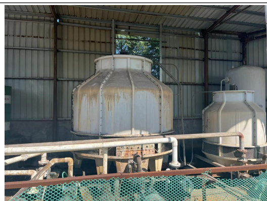
冷却塔回用管网
