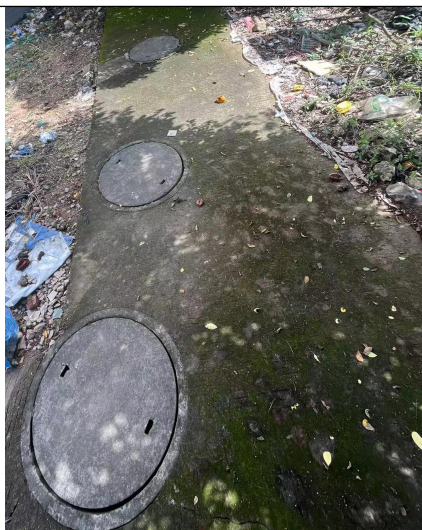
隔油隔渣池+三级化粪池
