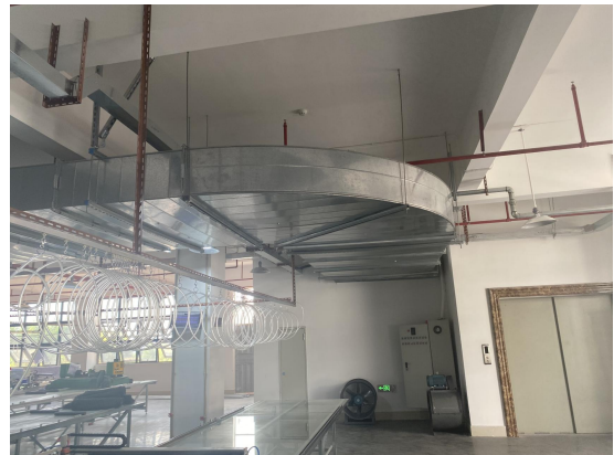
图2 印刷车间密闭及管道
