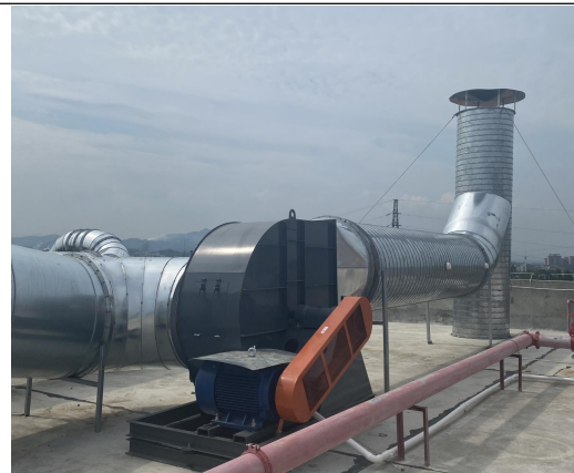
图4 排气筒（楼顶排放，约20m高）
