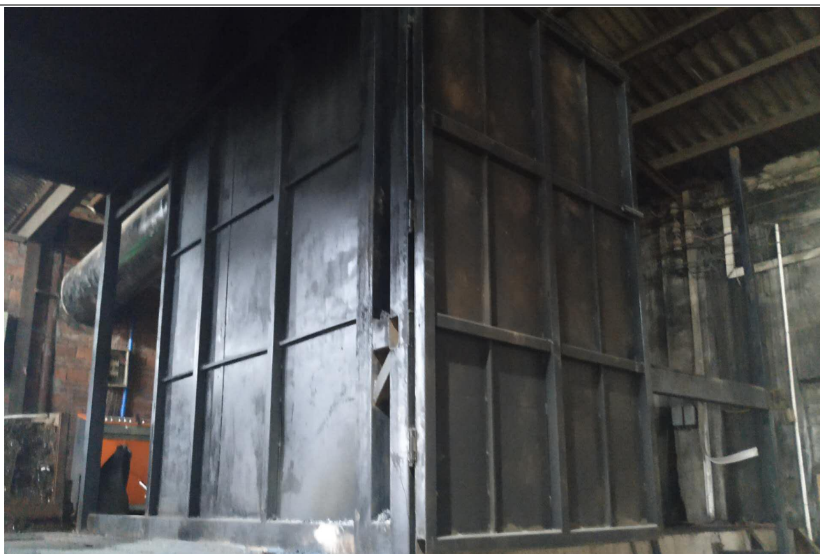
项目废气收集设施
