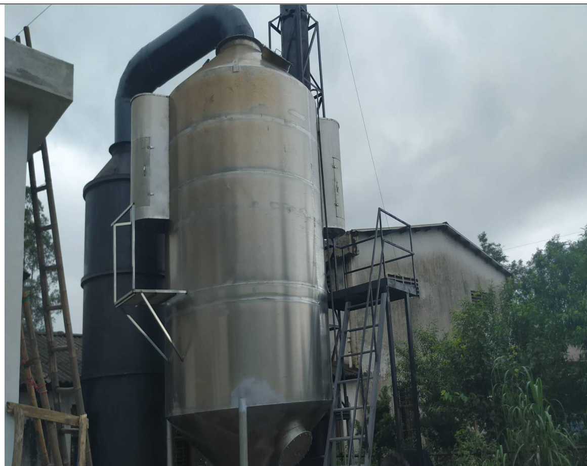
项目废气处理设施
